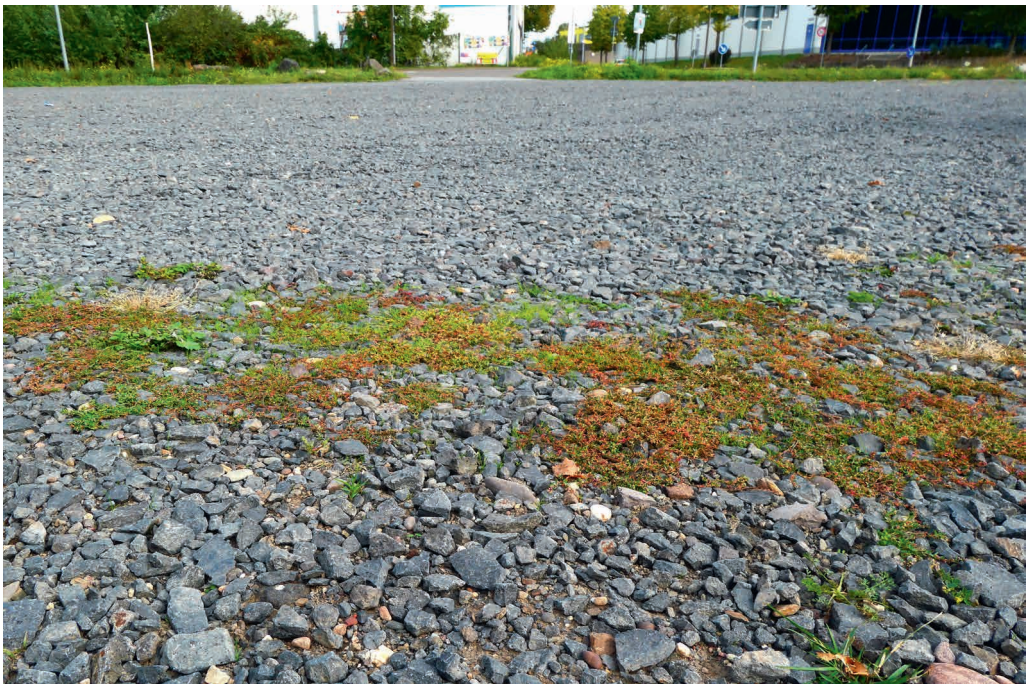
Abb. 28: Mit grobem, festgewalztem Basaltgrus gedeckte Parkplatzfläche bei sehr schütterem Bewuchs, vor allem mit Polygonum arenastrum subsp. calcatum . Andernach, 6.10.2024 – A parking lot covered with coarse, firmly rolled basalt grit with very shaky growth, especially with P. arenastrum subsp. calcatum . Andernach.
